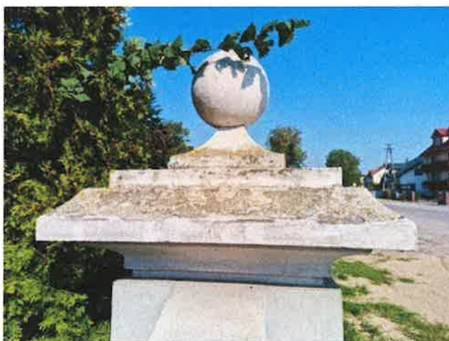
Widoczny nalot biologiczny na wszystkich elementach wierzchniej części bramy.
